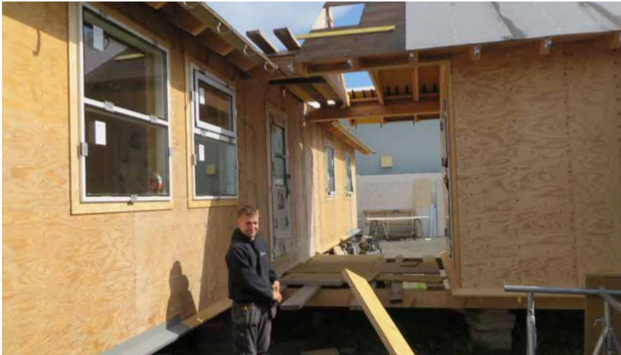
Mynd 7. Húseiningarnar voru byggðar á athafnasvæði verktaka að Laufásgötu 11, Akureyri, og fluttar í fimm einingum í Drekgil.
