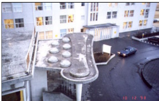
Svalir og skyggni yfir aðalinngangi fyrir viðgerð.
