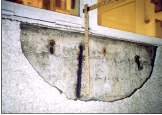
Ryðgað járn hefur sprengt burt múrklæðningu.
