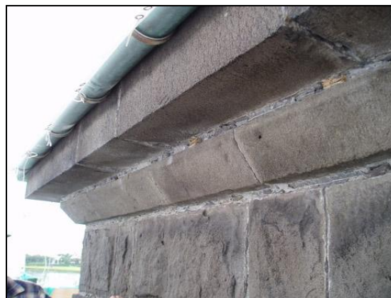
Fúgur voru morknaðar og veðraðar fyrir viðgerð.
